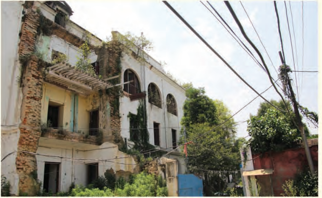
विगतमा आयोगको कार्यालय रहेको भूकम्पबाट क्षतिग्रस्त भवन ।
